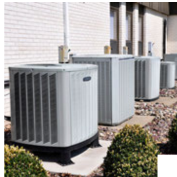
Hôpital Santa Luzia Elvas - Système de climatisation Elvas, Portugal Autorité régionale de la santé Assistance technique maîtrise d'ouvrage, contrôle et validation des plans, suivi et contrôle des travaux, coordination sécurité-santé sur chantier.
