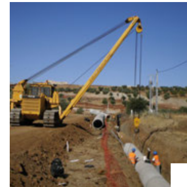
Infrastructures d'irrigation et de drainage du bloc de Pedrogão 3
