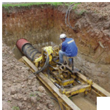
Réseaux d'irrigation du bloc sud de l'aménagement hydro-agricole de Vale da Vilarica
