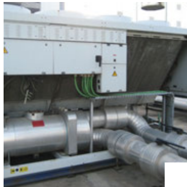
ALS - AVAC - centrale à froid n°2 - provisoire Lisboa, Portugal ANA Aeroportos de Portugal S.A Assistance technique maîtrise d'ouvrage, contrôle et approbation des plans, suivi et contrôle des travaux, coordination sécurité-santé sur chantier.
