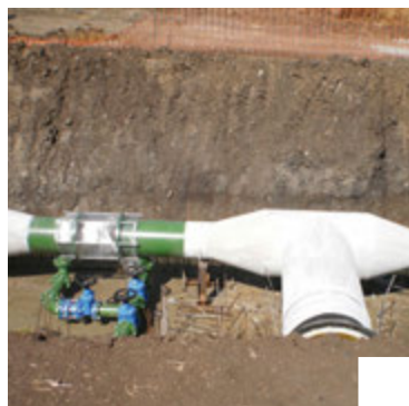
Infrastructures d'irrigation, routières et de drainage de l'aménagement hydro-agricole de Serpa
